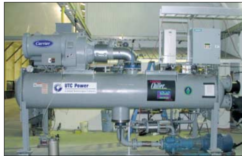
Kühlere Hitze: Das Kraftwerk Chena Chiller erzeugt schon mit 75 Grad heißem Wasser Strom
